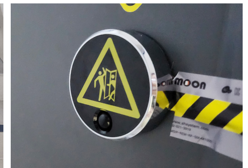
비상계단 방화문 출입 시 충돌 방지 조치
